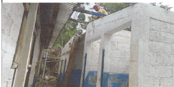
Foto 4: sacando láminas y puertas oxidadas de cuartos baños lavables
